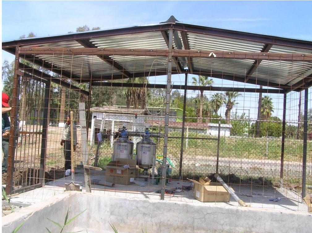
Sistema de Filtrado y Bombeo
